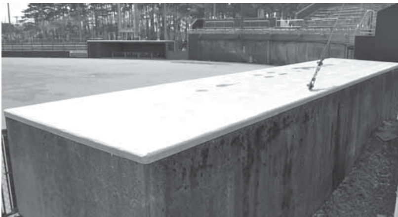
ダッグアウト内の雨漏りを防止するために屋根部にシートが貼られました
